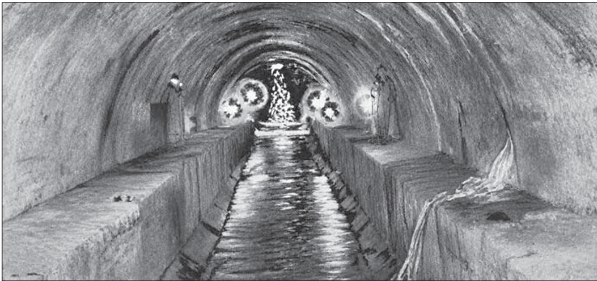
Підземне русло Полтви у перспективі. Бетонне склепіння. З правого боку ми бачимо один зі стоків, а точніше «притоку» бічного каналу. Вода та нечистоти стікають через банкетку до головного колектора. У глибині зафіксовано скидання снігу через вуличний отвір, званий «снігорозкидачем» (снігоприймачем). На банкетках видніються вогні карбідних ламп. (Фотогр. ред. Данилюк)
